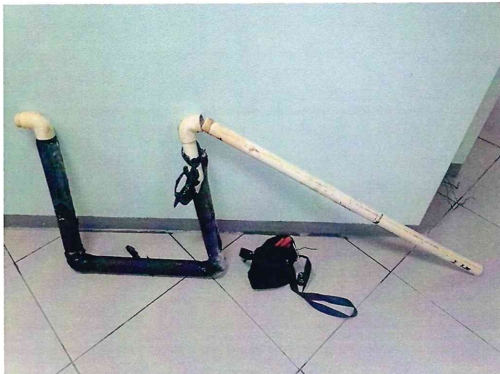
Пример разрушения ХПВХ трубопровода
