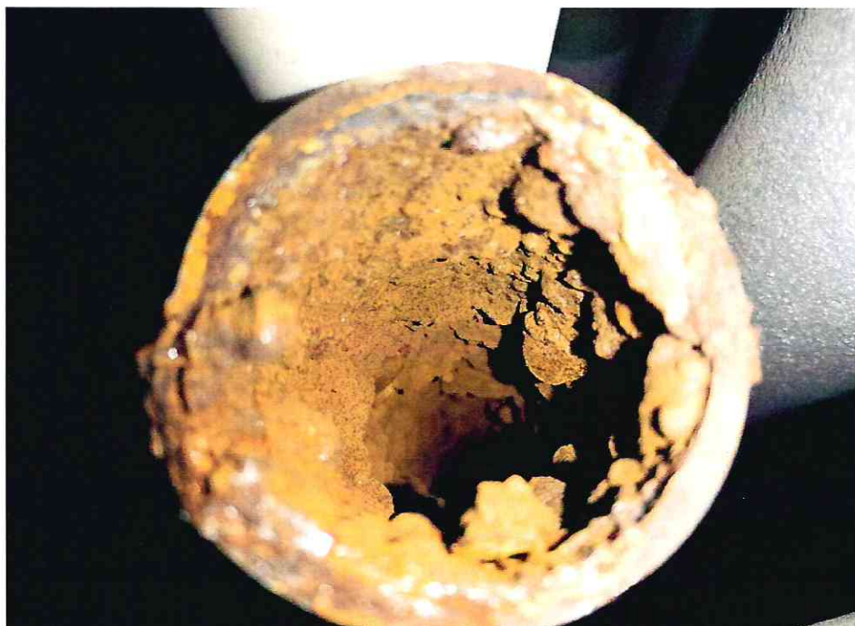
Коррозионные отложения оцинкованного стального трубопровода
